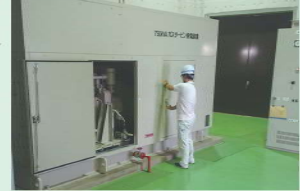
久寿家浄水場自家発電設備
