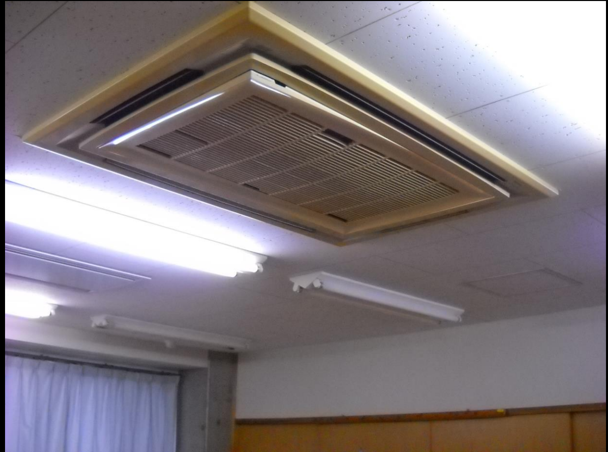
エアコンの吹き出し口（小工房A）
