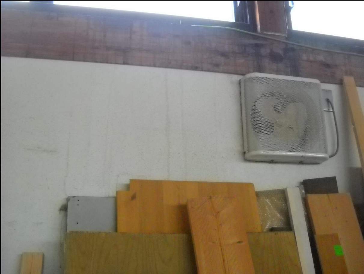
木質部分から壁面全体に雨水が染みている
