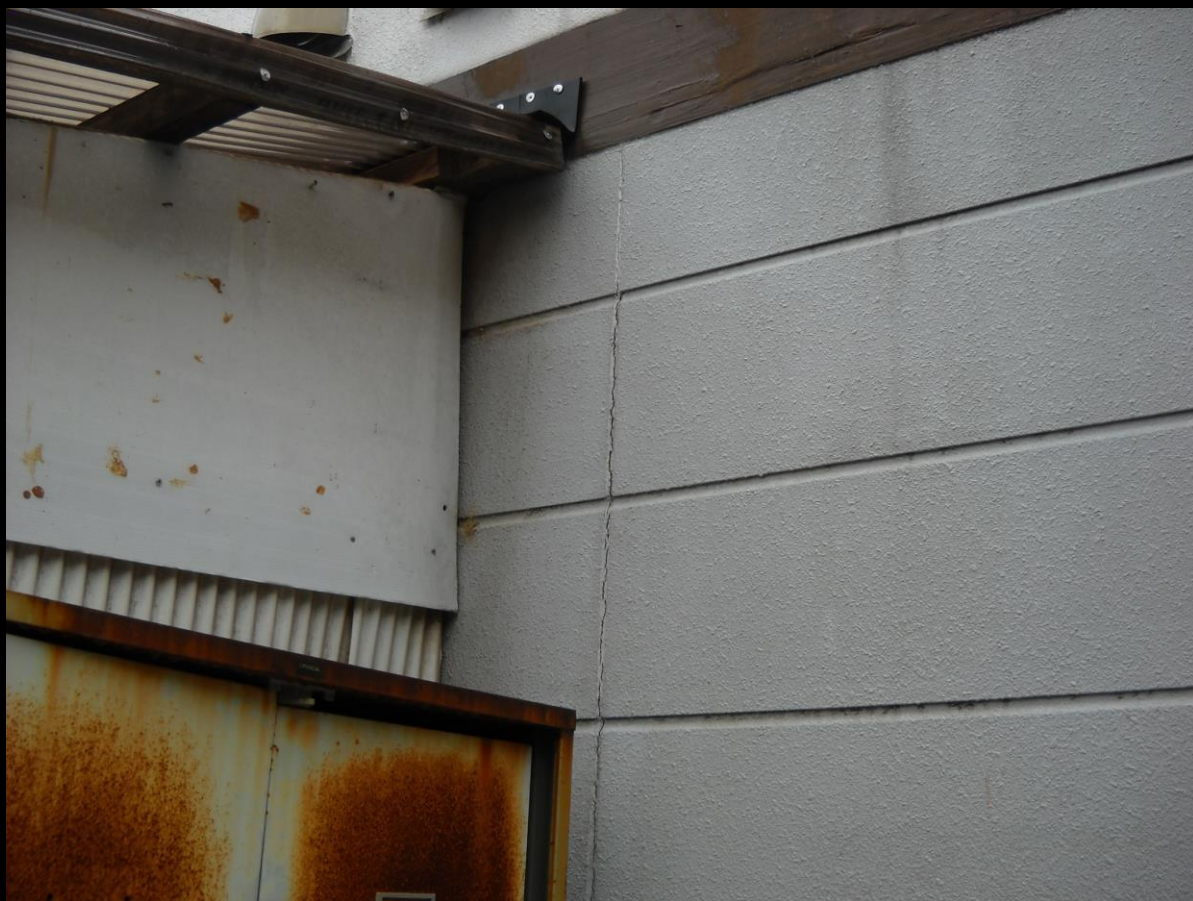
雨漏りの原因となっている天窓
