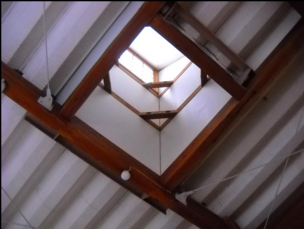
雨漏りの原因となっている天窗
