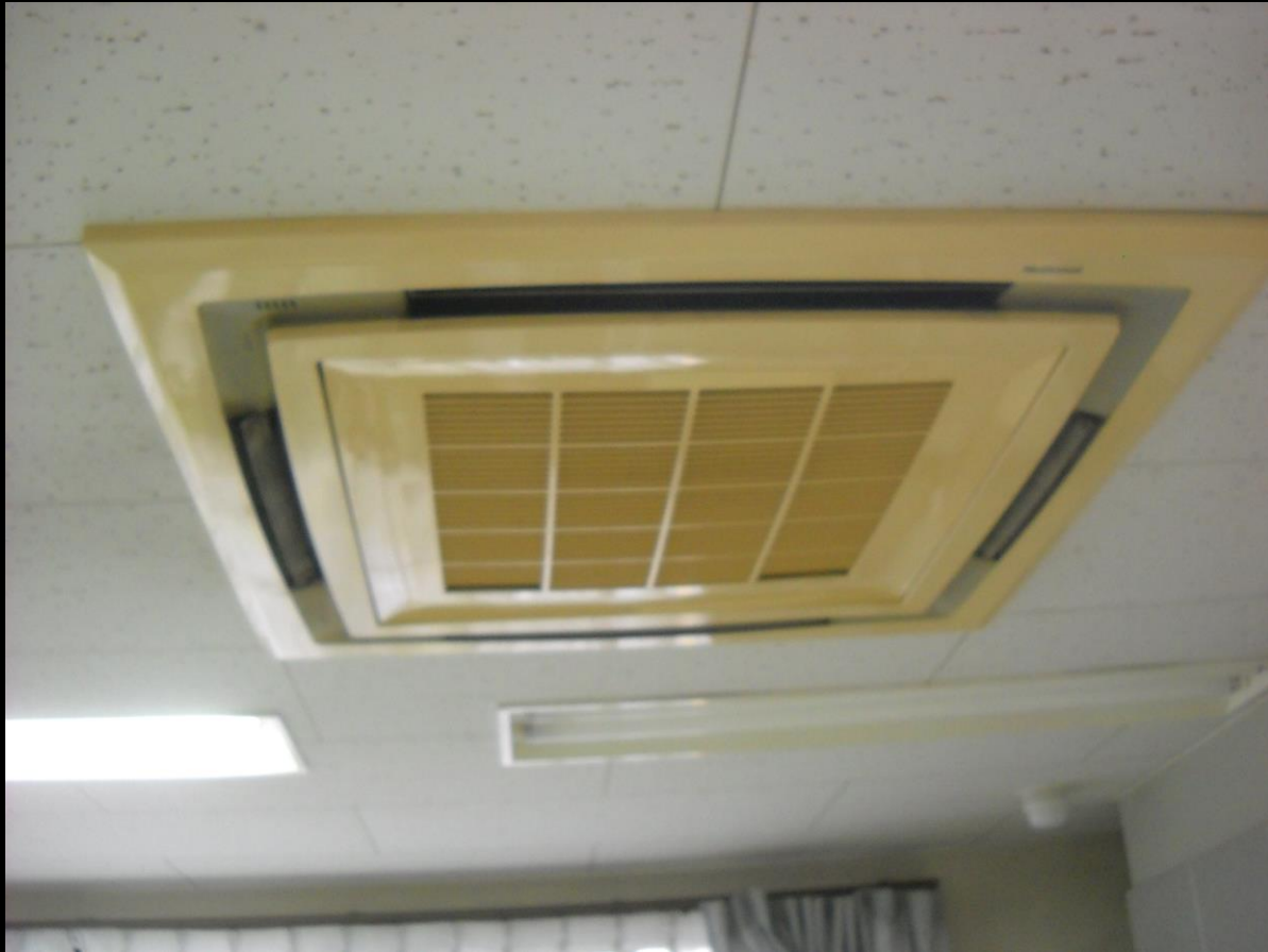
エアコンの吹き出し口（事務室）
