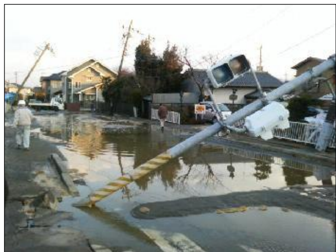
〈東日本大震災による液状化被害〉
