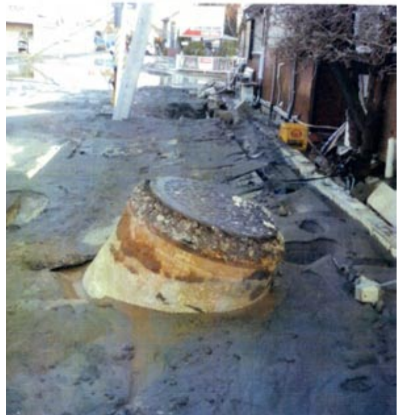
▲地盤沈下で飛び出たマンホール（布佐・都地区）
