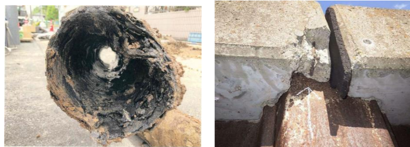
図4 老朽化した下水管(Zパイプ) 老朽化した雨水排水路
